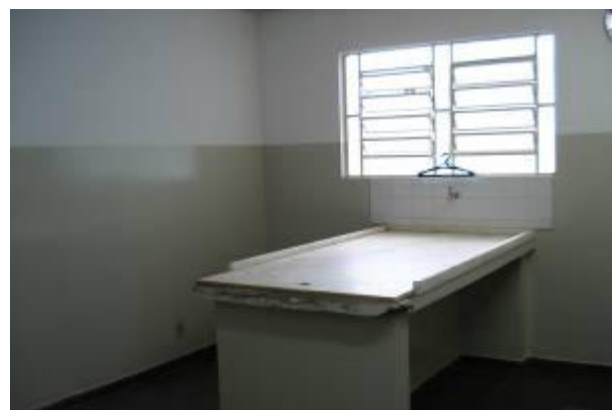
A mesa onde é feita a necropsia está inadequada às normas técnicas (SS-28). EPML Barretos UR-08
