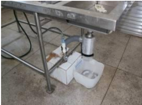
Mesa utilizada para realização de necropsias apresentando vazamento. EPML Presidente Prudente UR-05
