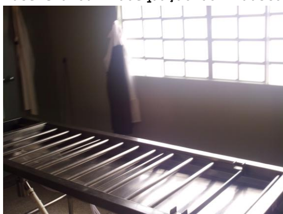
Sala onde é realizada a necropsia não possui sistema de exaustão e renovação de ar forçada. EPML Penápolis UR-01
