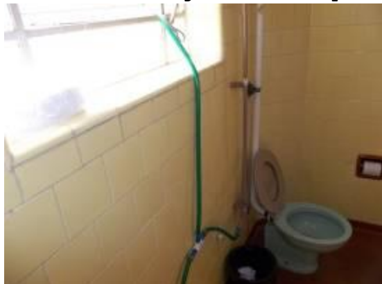
Ligação da água da rua por mangueiras, devido ao encanamento estar podre EPC Osasco DCG-2
