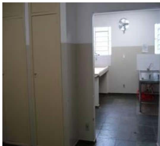
O espaço é insuficiente e não possui câmara de refrigeração. EPML Barretos UR-08
