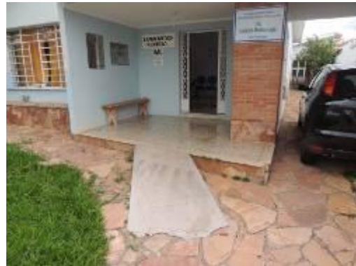
Entrada do IML - ausência de corrimão na rampa.
