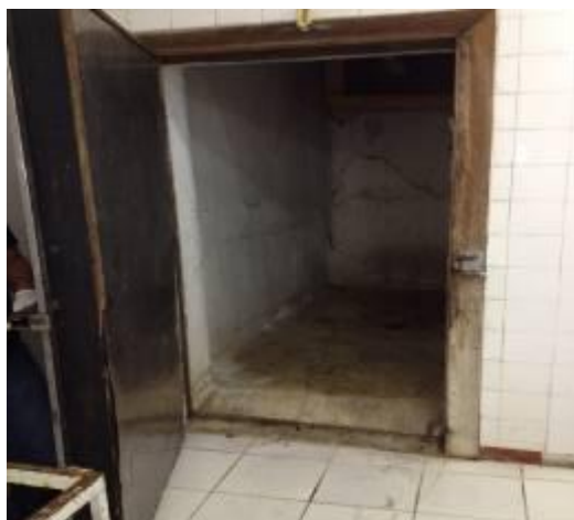
Câmara de refrigeração sem gavetas ou prateleiras para acomodação de cadáveres EPML São Sebastião UR-07
