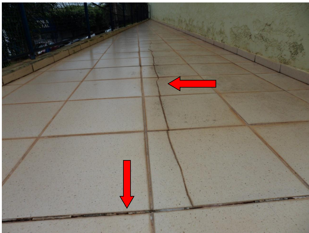
Ilustração 17 – Detalhe da trinca do terraço A
