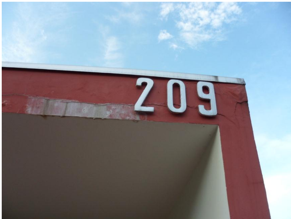
Ilustração 13 – Trinca com percolação de água
