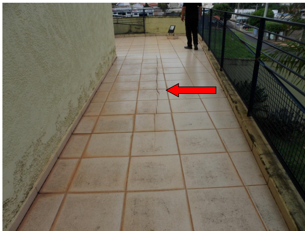
Ilustração 16 – Trinca no revestimento do terraço A
