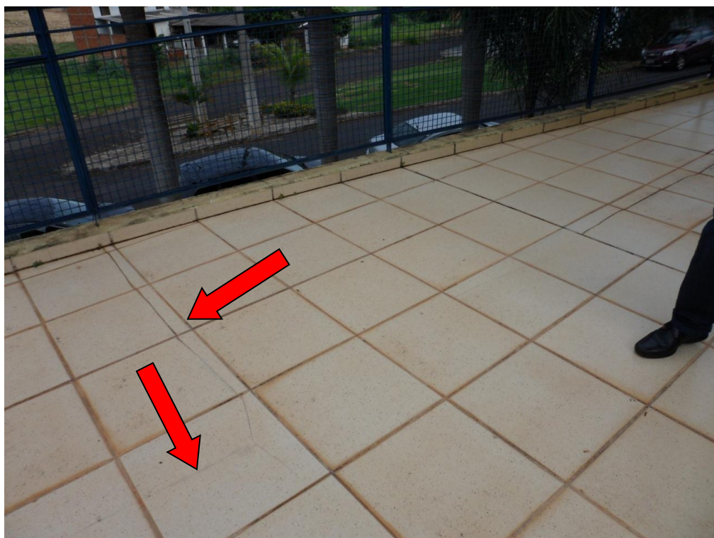
Ilustração 18 – Trincas nos terraços A e B
