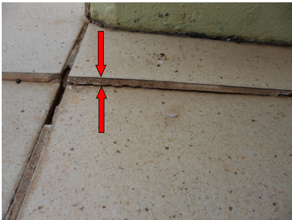
Ilustração 15 – Evidência de movimentação da laje do terraço B
