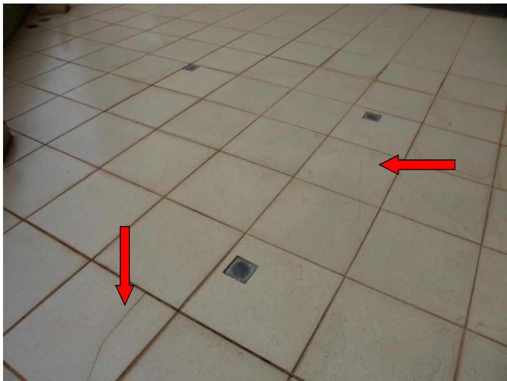
Ilustração 14 – Fissuras no revestimento do piso
