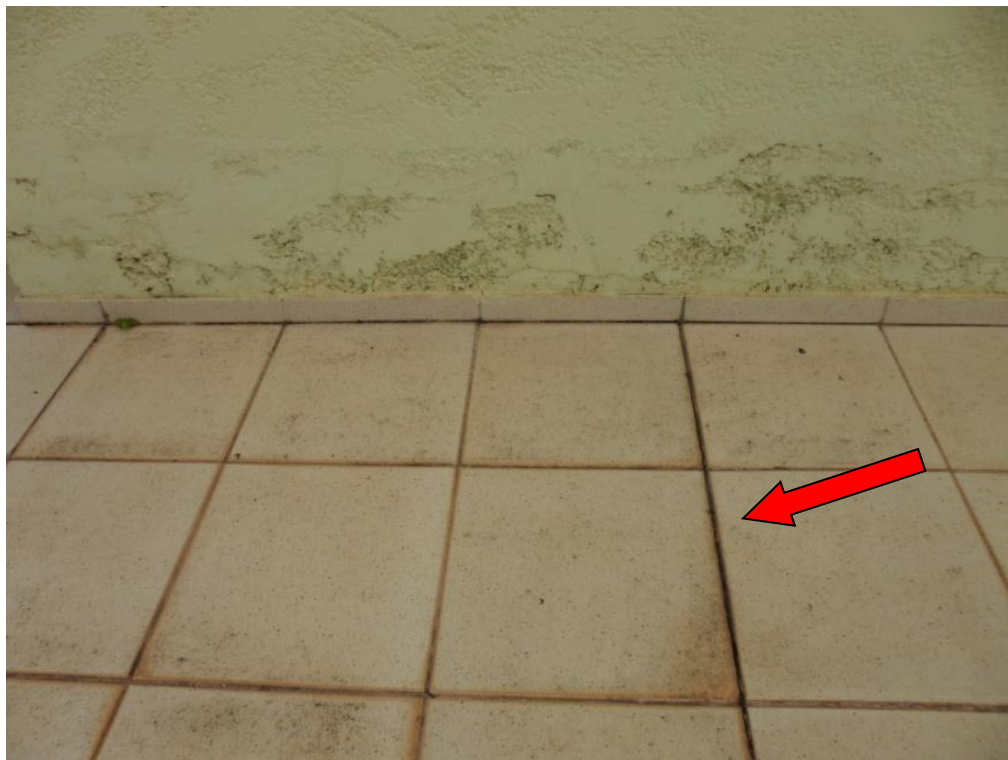
Ilustração 19 – Movimentação do revestimento do piso do terraço B
