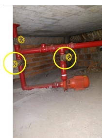
Figura 3 – Registros a realizar manutenção
