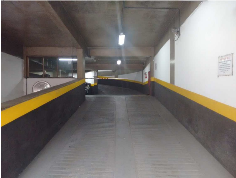
Figura 9: Detalhe de um ponto de acesso do Edifício Anexo II na Rua Bittencourt Rodrigues
