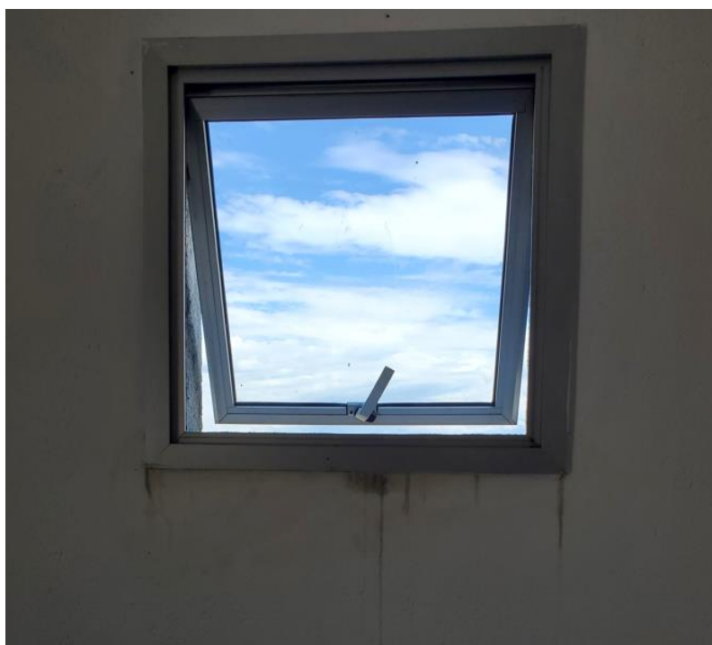
Imagem 11 – Lado interno da janela que terá o peitoril substituído.
