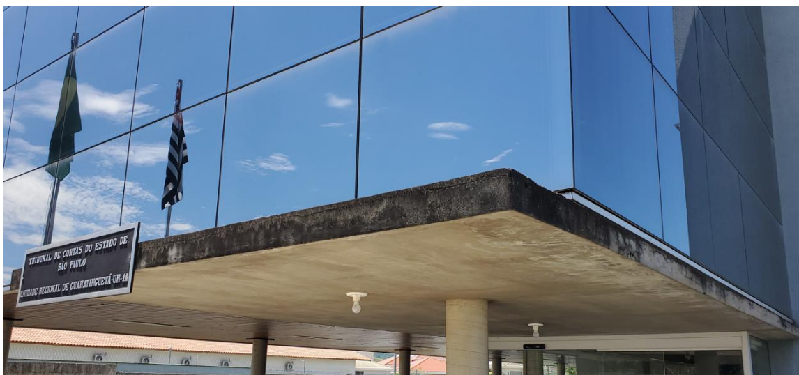
Imagem 7 – Marquise que deverá ser revestida com ACM em sua poção superior e lateral.
