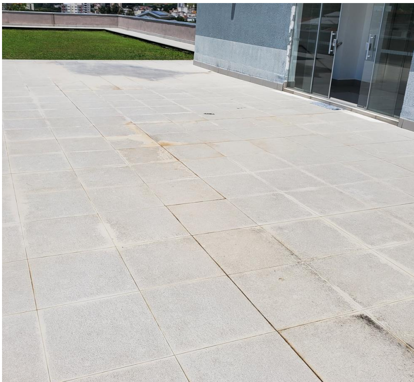
Imagem 10 – Revestimento cerâmico a ser limpo e ter parte de seu rejunte recomposto.
