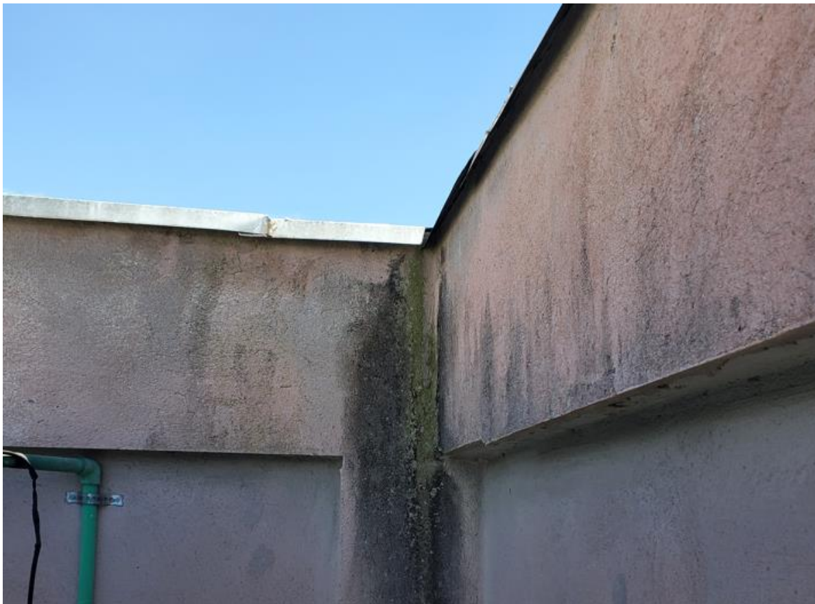
Imagem 3 – Visão de parte do muro do rufo a ser removido na cobertura.
