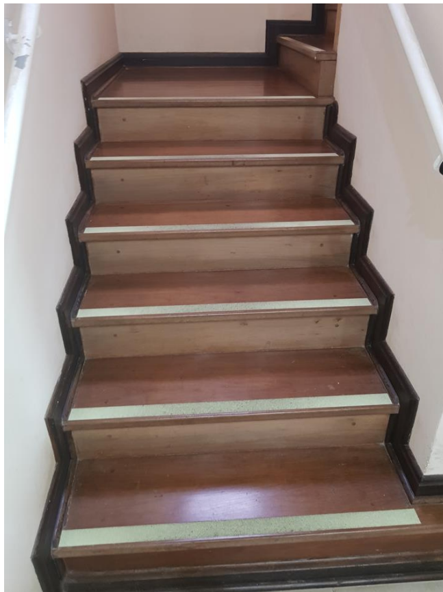
Imagem 13 – Escada de madeira a ser recuperada.
