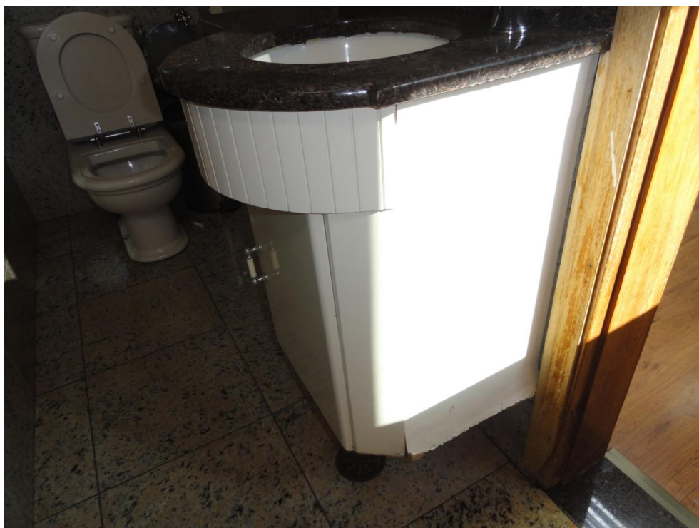
Foto 03 – Gabinete de lavatório a ser trocado.
