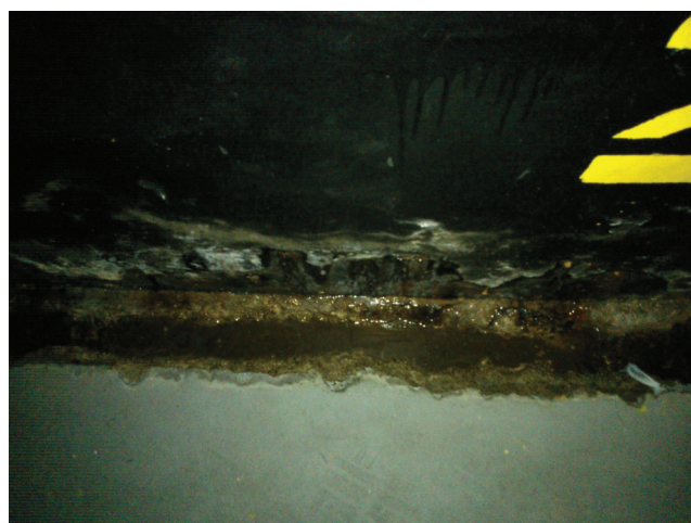
Imagem 13 c— Alvenaria localizada junto ao box nº 25
