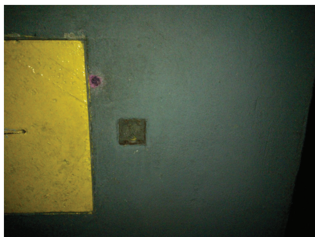
Imagem 12 c— Caixa de inspeção da caixa d'água auxiliar
