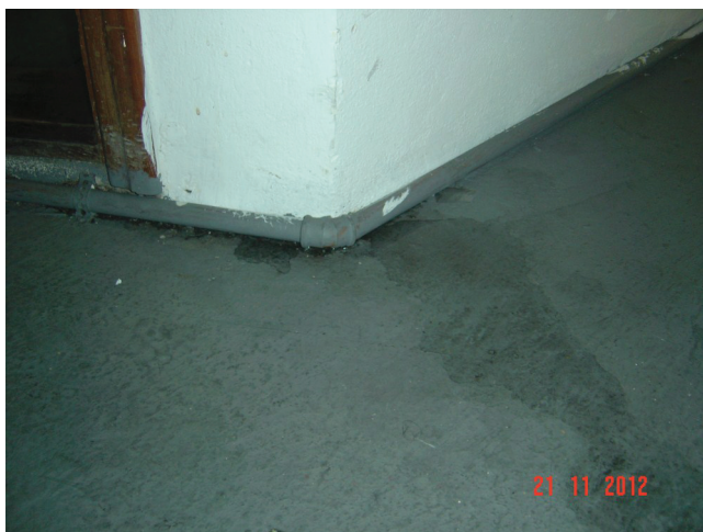
Imagem 07 a—Dreno do ar condicionado junto à alvenaria da sala dos mensageiros
