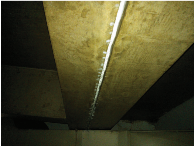
Imagem 01 a— Viga ao lado da casa de ar condicionado
