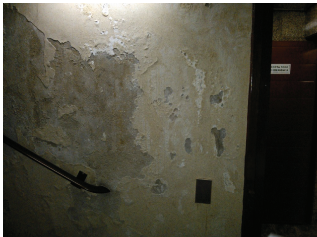
Imagem 06 c— Alvenaria da face interna da caixa de escada de acesso ao 2º subsolo
