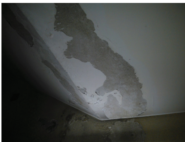
Imagem 06 b— Forro da face interna da caixa de escada de acesso ao 2º subsolo
