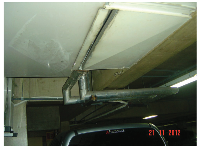
Imagem 06 — Tubulação de ar condicionado ao lado da alvenaria da sala dos mensageiros
