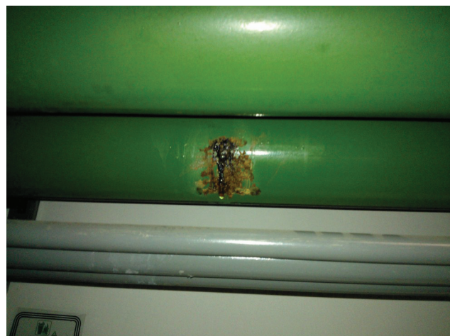
Imagem 01 b— Tubulação localizada na laje junto ao box nº 12
