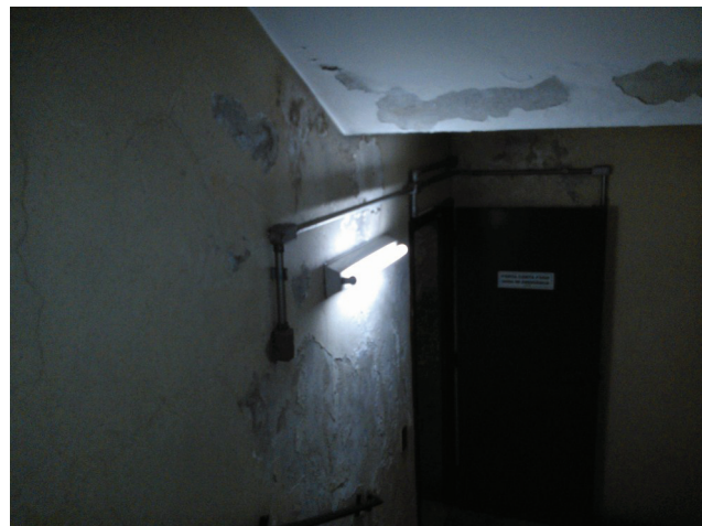
Imagem 07— Alvenaria da face interna da caixa de escada de acesso ao 2º subsolo
