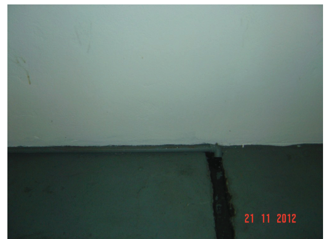
Imagem 07 b— Dreno do ar condicionado junto à alvenaria da sala dos mensageiros
