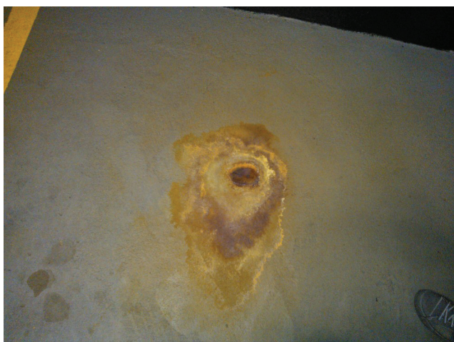
Imagem 01 c— Piso abaixo da tubulação localizada na laje junto ao box nº 12
