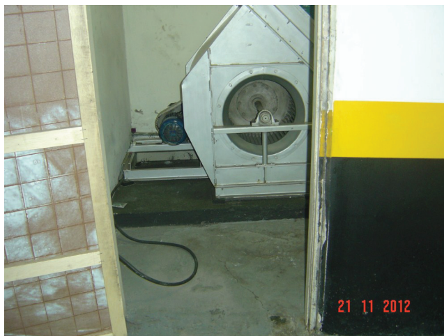
Imagem 02 a— Cabine do ar condicionado
