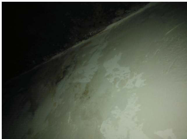
Imagem 04 b— Alvenaria entre a cabine de ar condicionado e o box nº 29 (vista superior)
