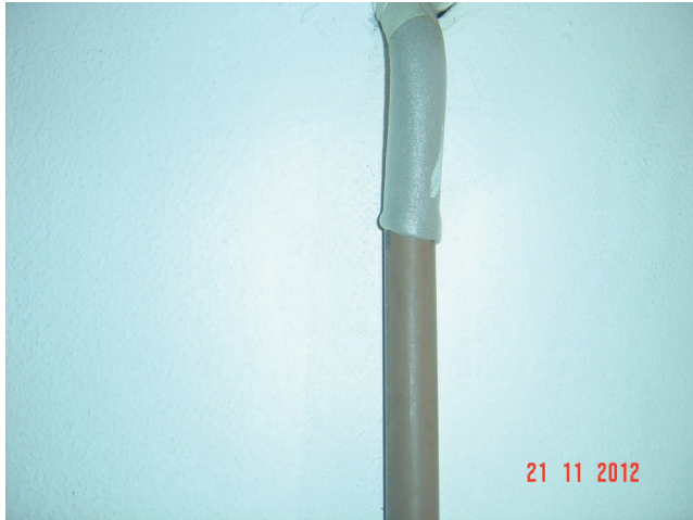
Imagem 07 c— Tubulação de ar condicionado em frente à alvenaria da sala dos mensageiros
