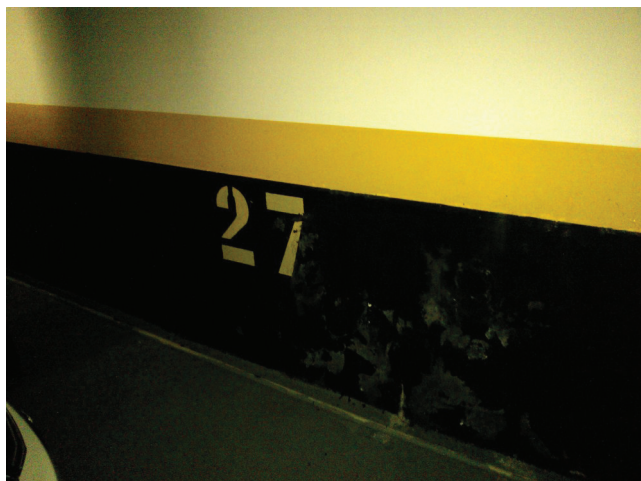
Imagem 04 a— Alvenaria externa do reservatório inferior junto ao box nº 27
