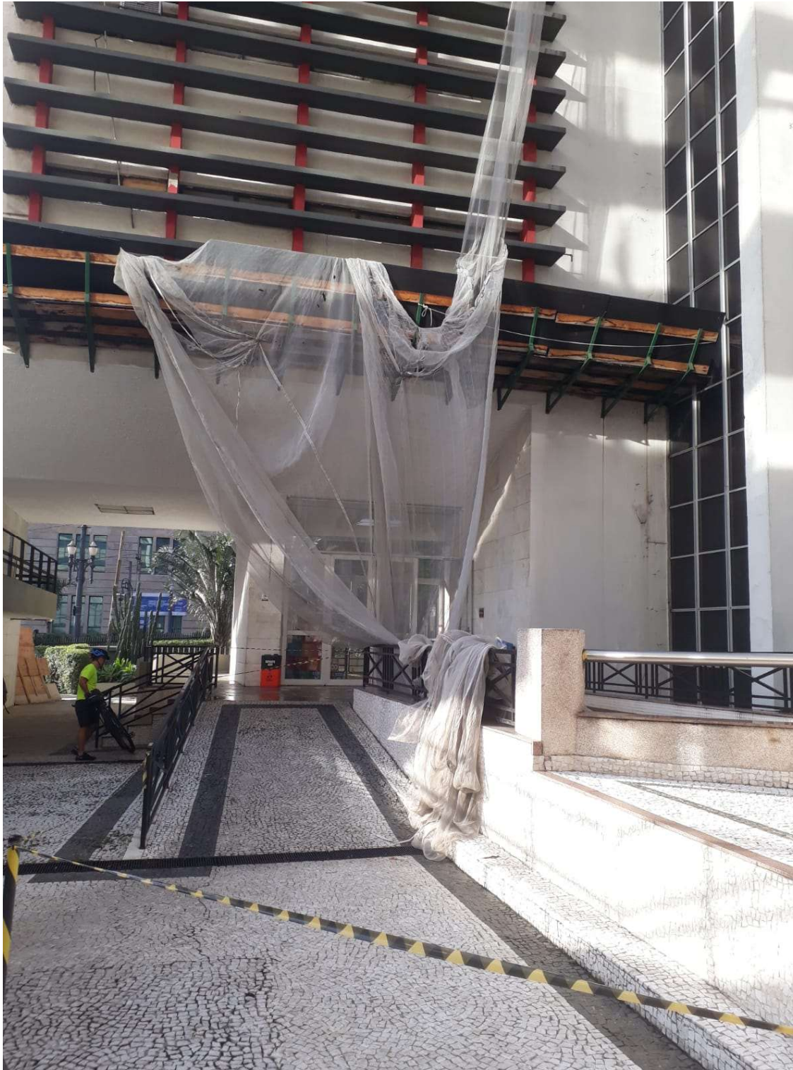
Foto 1 – Queda da tela fachadeira.
