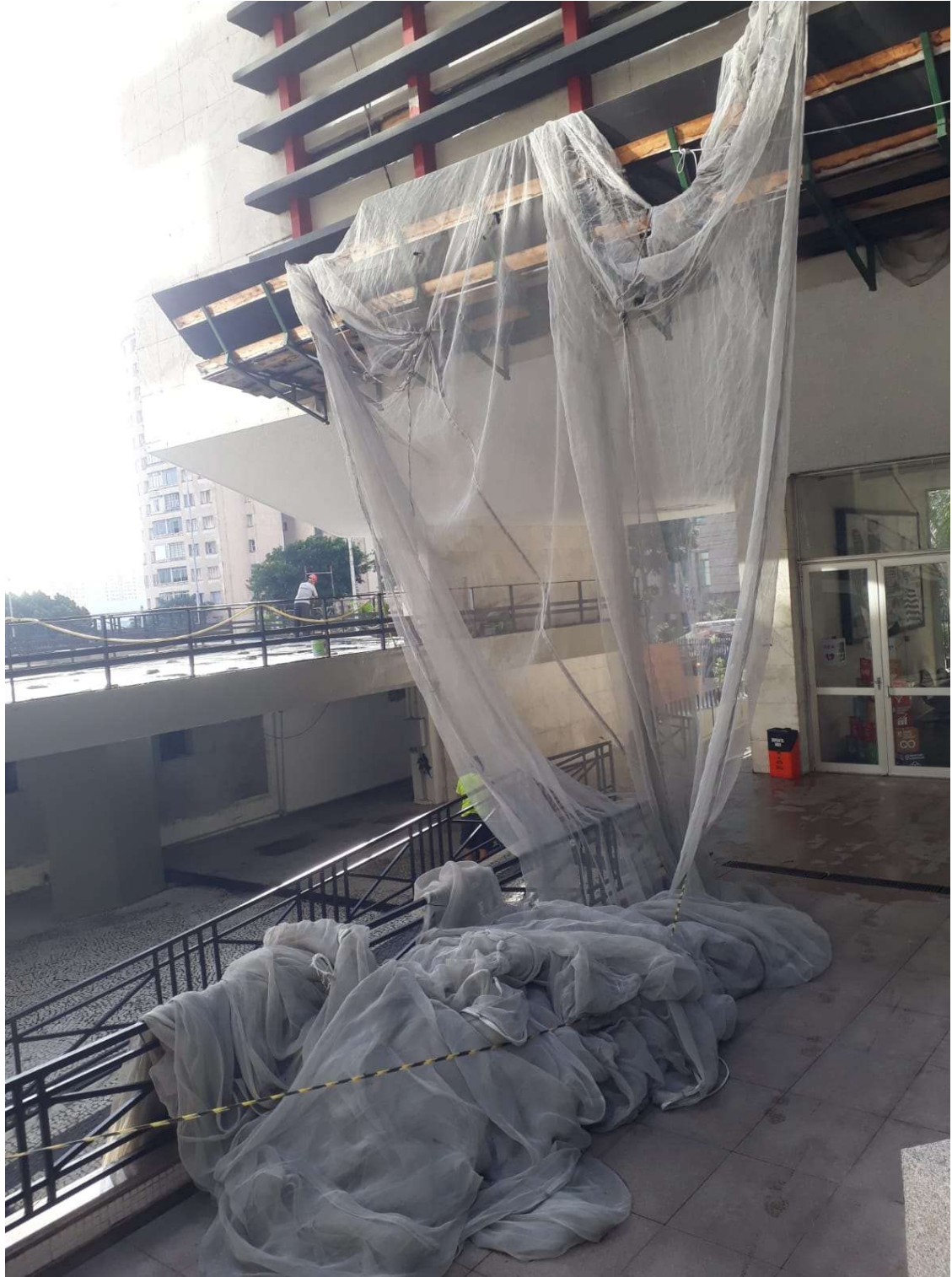
Foto 2 – Queda da tela fachadeira.
