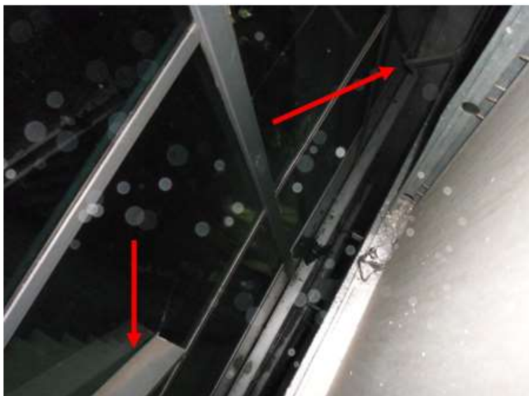
Foto 3 – Pontos de ancoragem da estrutura prejudicados.
