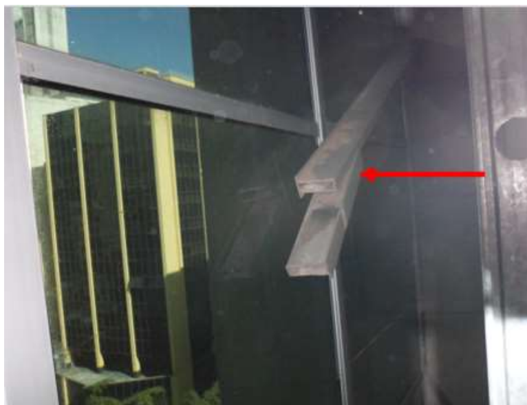
Foto 4 – Travessa de sustentação rompida.
