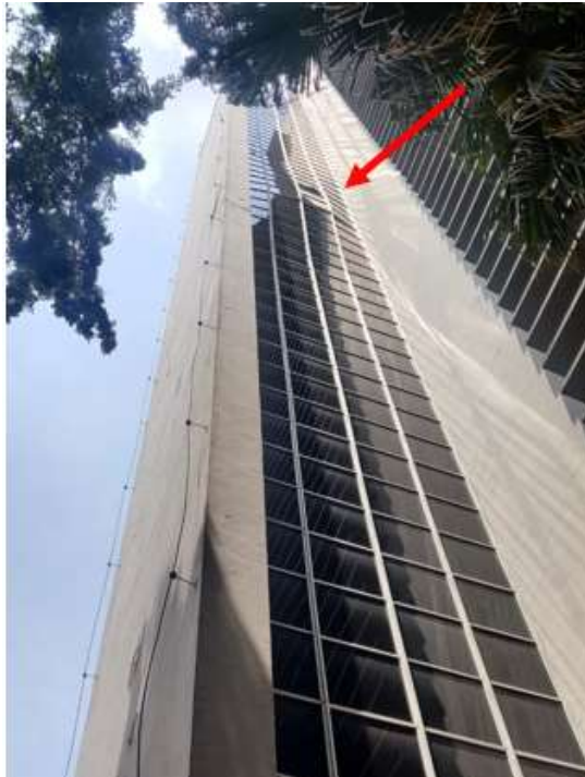
Foto 1 – Alinhamento de montante e painéis da pele de vidro prejudicados.
