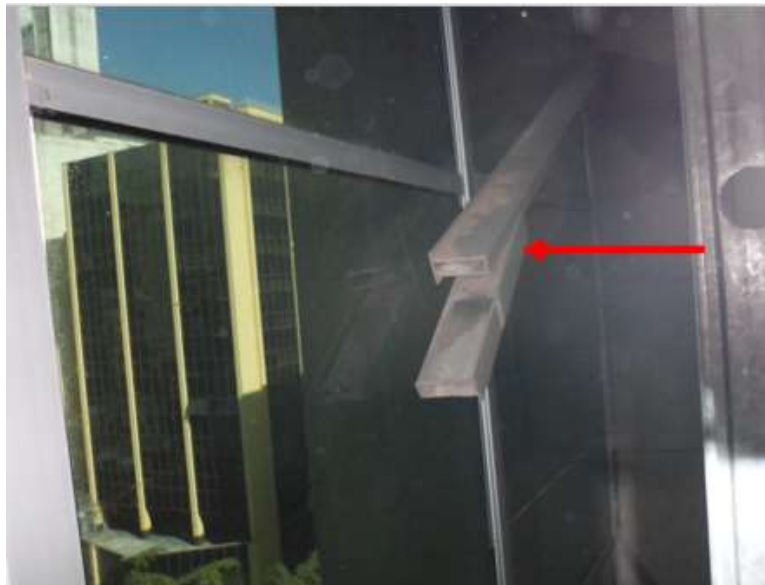
Foto 4 – Travessa de sustentação rompida.
