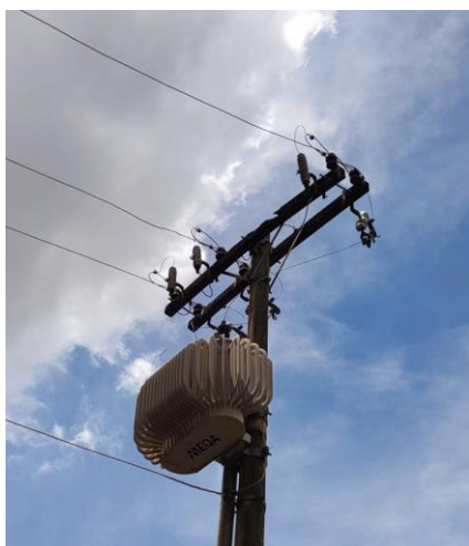
Foto 1 – Cruzeta de madeira parcialmente rompida risco de queda.
