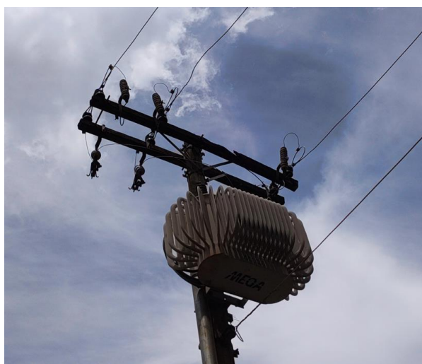
Foto 2 – Cruzeta parcialmente rompida risco de queda.
