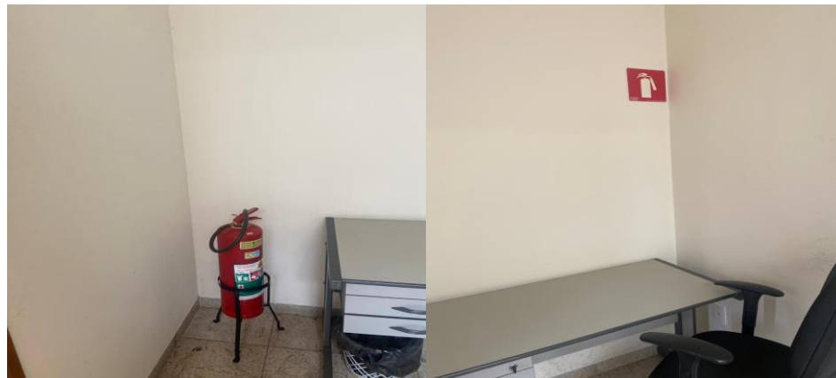
Imagens 4 e 5: Extintor de Água Pressurizada – Classe A (Válido até Setembro/2022) e instalado na entrada da edificação bem como sua sinalização correspondente.
