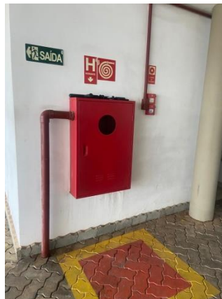
Imagem 12: Hidrante Pavimento Térreo
