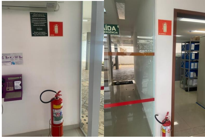
Imagem 2 e 3: Extintores instalados no térreo (Recepção)
