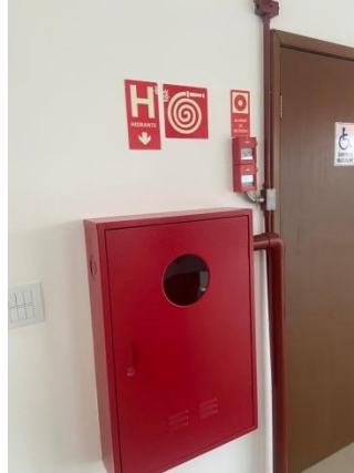
Imagem 13: Hidrante Primeiro Pavimento (Pav. Superior)
