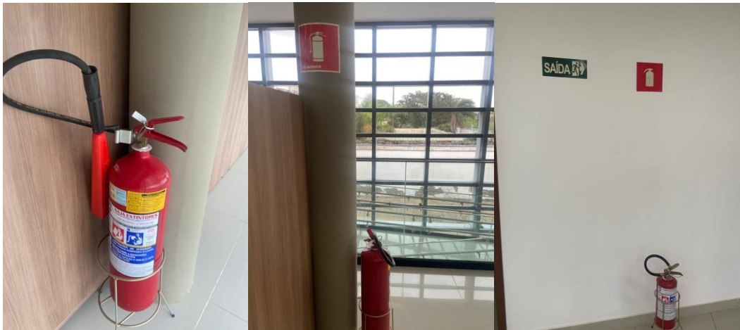
Imagem 9, 10 e 11: Extintores do Primeiro Pavimento (Pav. – Superior)
