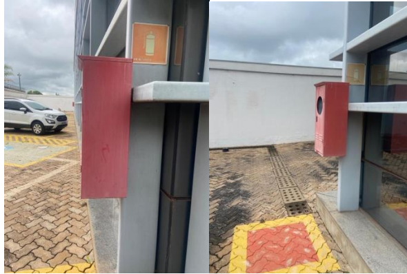
Imagem 7 e 8: Extintores do Pavimento Térreo (Externo - Estacionamento)
