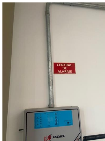
Imagem 16: Central de alarme localizada na recepção do térreo.
