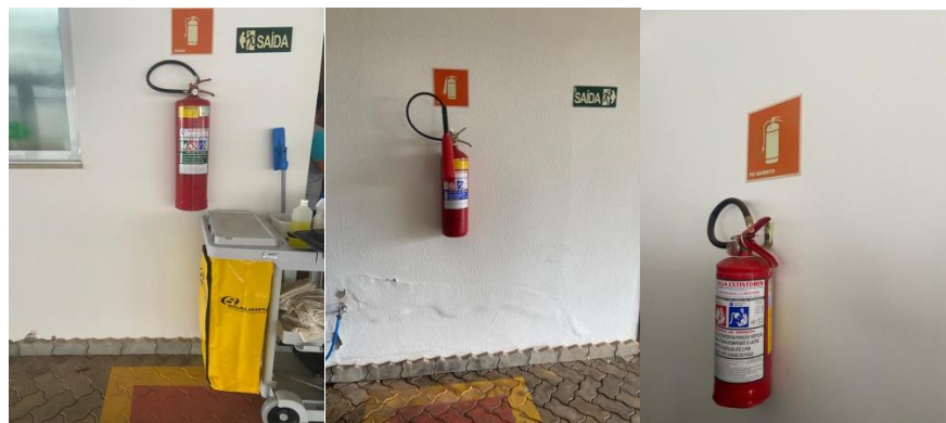
Imagem 4, 5 e 6: Extintores do Pavimento Térreo (Externo – Estacionamento)
