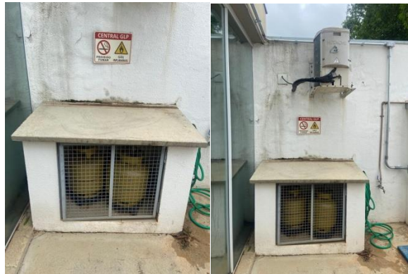
Imagem 14 e 15: Central de Gás com sinalização de proibido fumar (P1)
