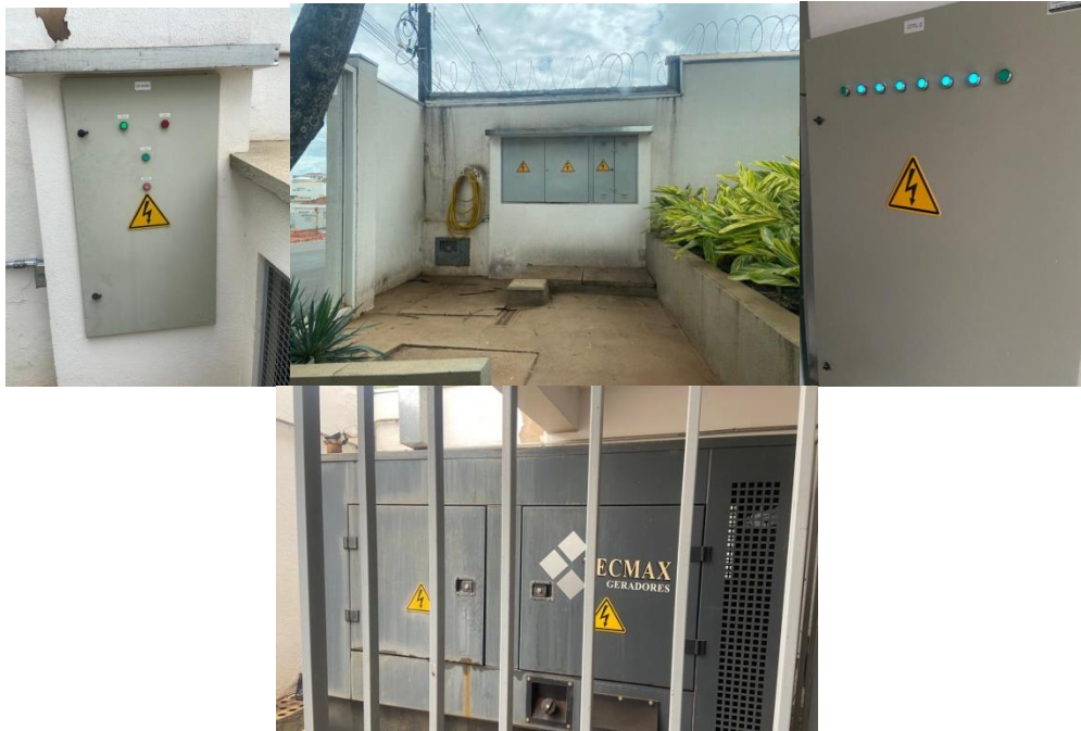
Imagem 20, 21, 22 e 23: Imagens de quadro de energia e Gerador com sinalização de emergência.
