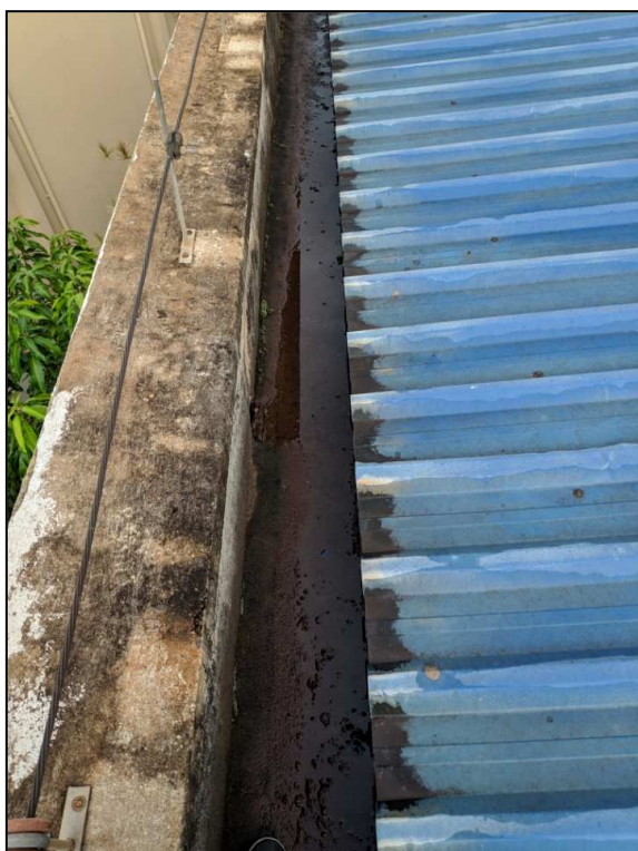
Imagem 3 – Calha com deficiência no escoamento
