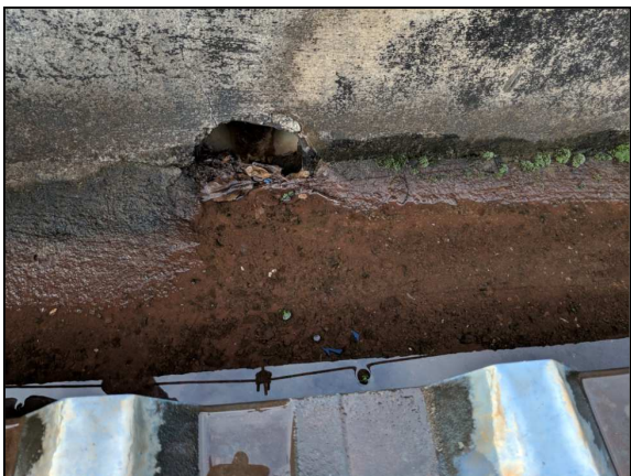
Imagem 5 – Deficiência no escoamento
