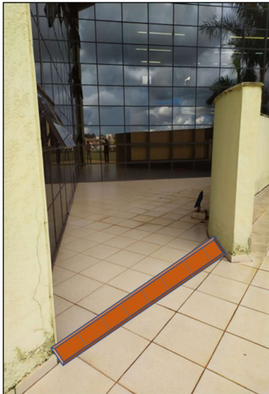
Foto 08 – Foto ilustrativa do local onde será instalada a barreira de alvenaria sobre a laje do terraço
