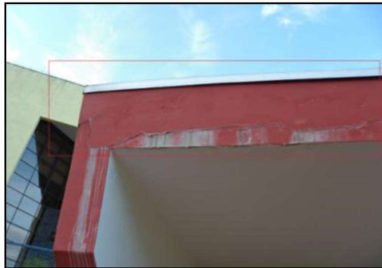
Foto 01 – Foto ilustrativa de mureta e alvenaria a serem tratados
