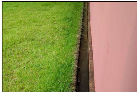
Foto 13 – Foto ilustrativa de tubos de PVC existentes atualmente
