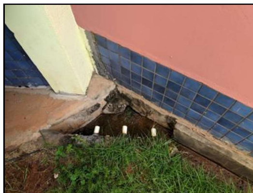
Foto 14 – Foto ilustrativa de tubos de PVC existentes atualmente
