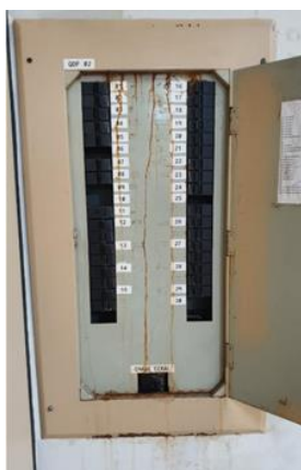
Figura 7 – Quadro de distribuição elétrica do pavimento superior a ser substituído (QDE).
