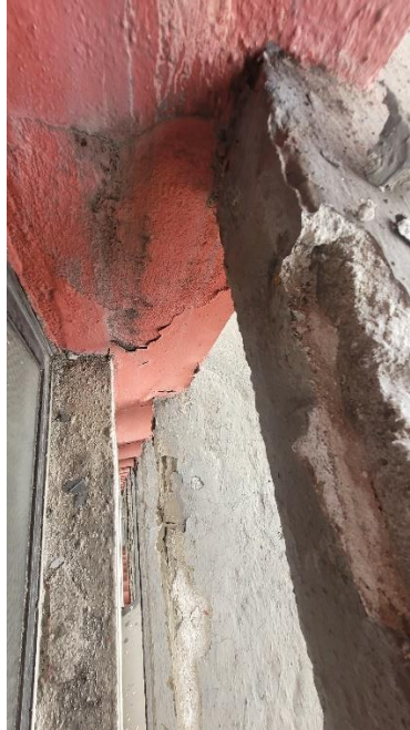
Detalhe dos pilaretes de fixação dos brises com deslocamento da argamassa de revestimento. Foto outubro de 2022, acervo CDHU
