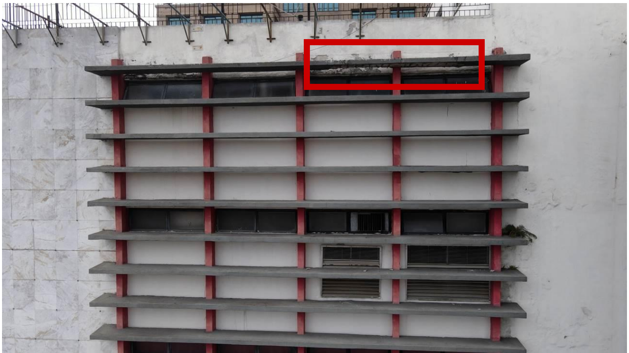
Foto 17 – Vista do lado A, brise 73, com armaduras expostas.
