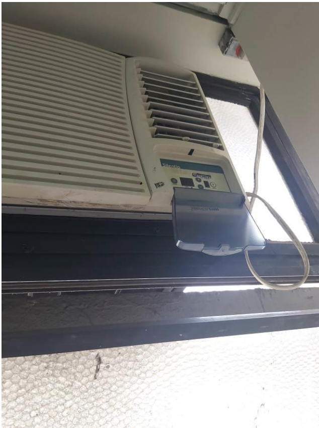
Foto 11 – Brise 24, lado B, com aparelho de ar condicionado apoiado.
