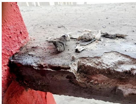
Detalhe dos brises com deslocamento da argamassa de revestimento. Foto outubro de 2022, acervo CDHU
