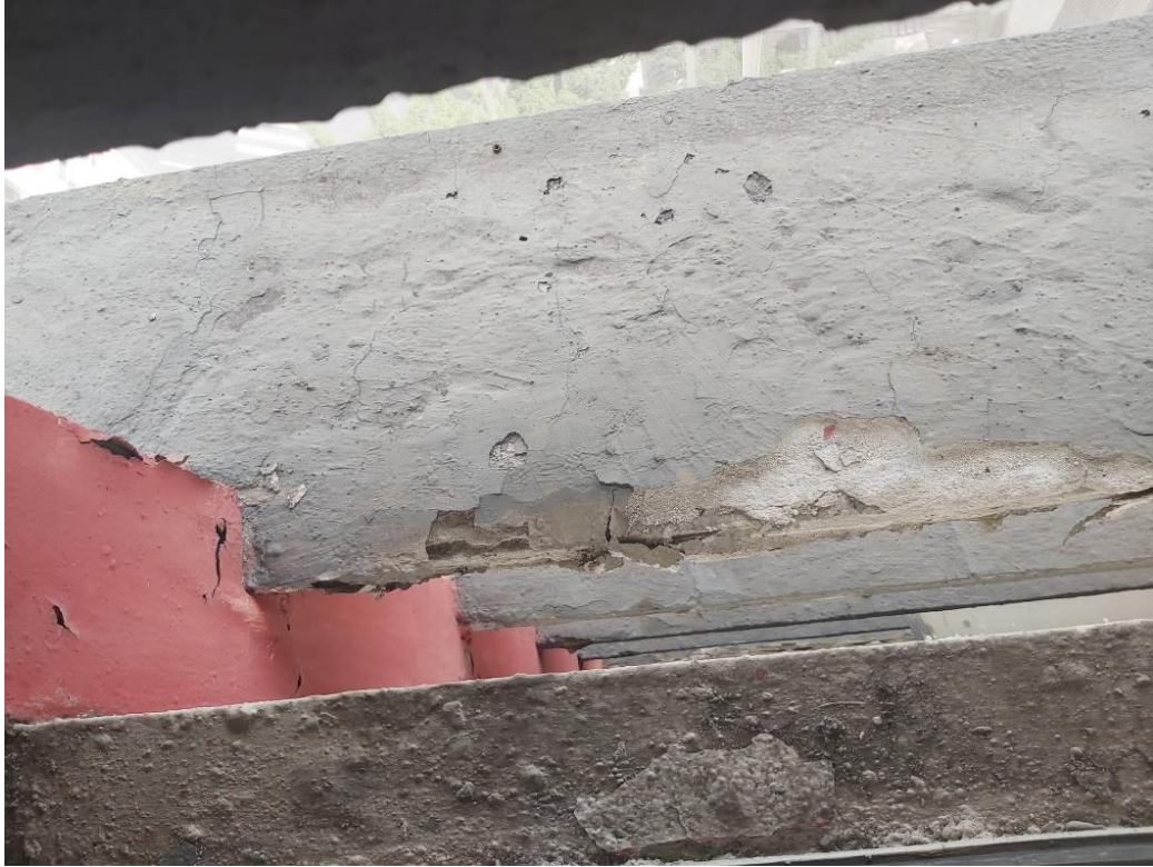
Foto 13 – Brise 50, lado B, e inferiores, e PT.10, com deslocamento do revestimento.
