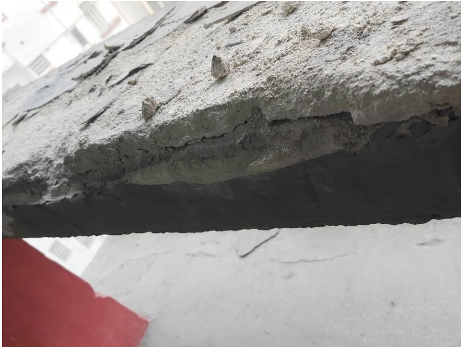
Foto 9 – Brise 31, lado B, com deslocamento do revestimento.
