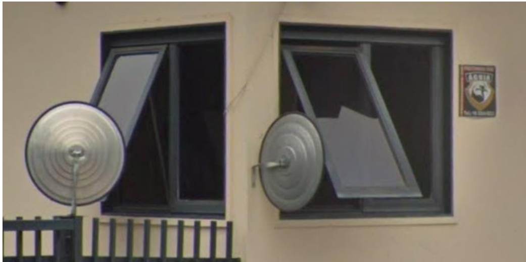
Foto 2 – Janela Maxim-ar da guarita
